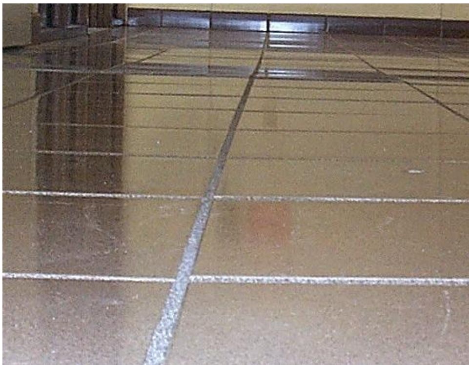
Picture 1-1 – Las baldosas de gran formato resaltan las imperfecciones en el sustrato.
