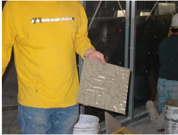
Picture 1.4 – Baldosa cerámica retirada durante la instalación para verificar que se está alcanzando la cobertura adecuada. Observe que la esquina inferior derecha de la baldosa carece de cobertura. Esto sin duda conducirá a una baldosa agrietada.
