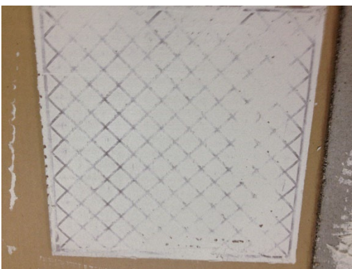
Figura 1: Baldosa de gran formato con mortero en la parte posterior aplicado correctamente.
